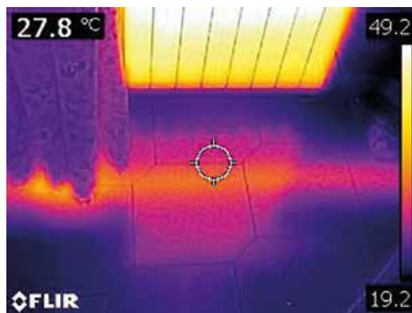
Vista di un termosifone con alla base il percorso del tubo di arrivo dell'acqua (foto L. Ghoniem)
